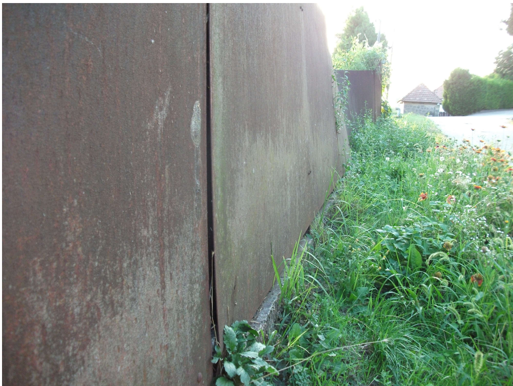
2.kép: A kibillent támfal feletti kerítés a lábuzatával együtt szintén elbillent, a deformáció már dm-es nagyságú. A közút melletti padkán emiatt hosszanti övrepedések keletkeztek, a legnagyobb a kerítés lábuzatának tövében jelent meg, mutatva a horizontális mozgásokat.
