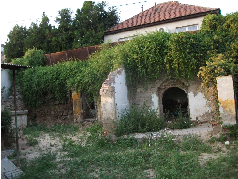
1.kép: A Petőfi u. 11. előtt (Rákóczi u. 5. mögött) a régi melléképület megsemmisült, annak romjait elbontották. A felső utat támasztó hátsó támfal elbillent, eldeformálódott, a falazati elemek kihullaottak. Két pince indult a támfalból, a képen látható jobb oldali bélelt pince nem igényel beavatkozást.
