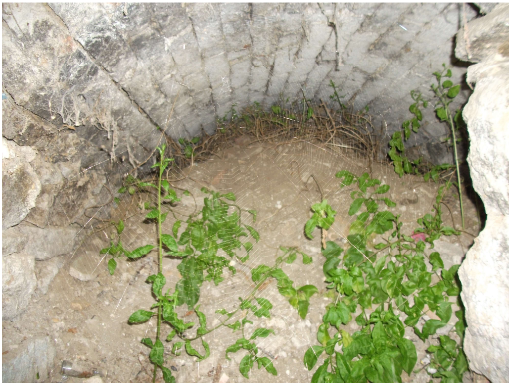
4.kép: A támfalból induló bal oldali pincét házilagosan , laza anyaggal betöltötték. Valószínűleg a pince vége a felső út alatt üresen maradhatott. Bányászati feltárás után a pince ráinjektálásos módszerrel tömedékelendő.
