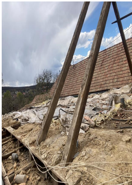
3. Törmelékes padlásfödém tornác mentén
